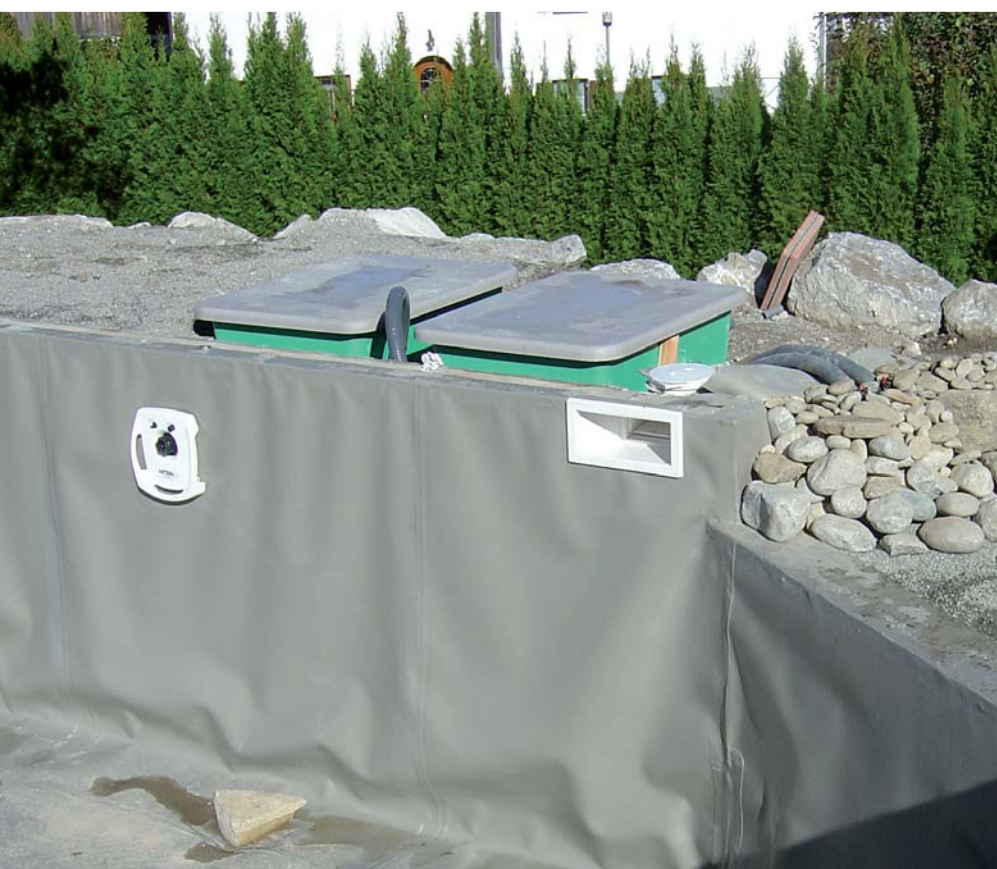
Technikschächte: Filterpumpe, Gegenstromanlage und eingebauter Skimmer
