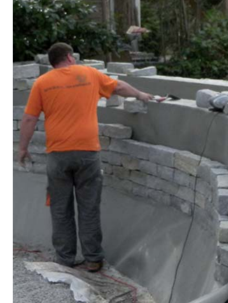
Verkleidung des erhöhten Regenerationsbeckens mit Gneissteinen
